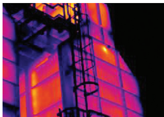
石油精錬所におけるガス漏れ
